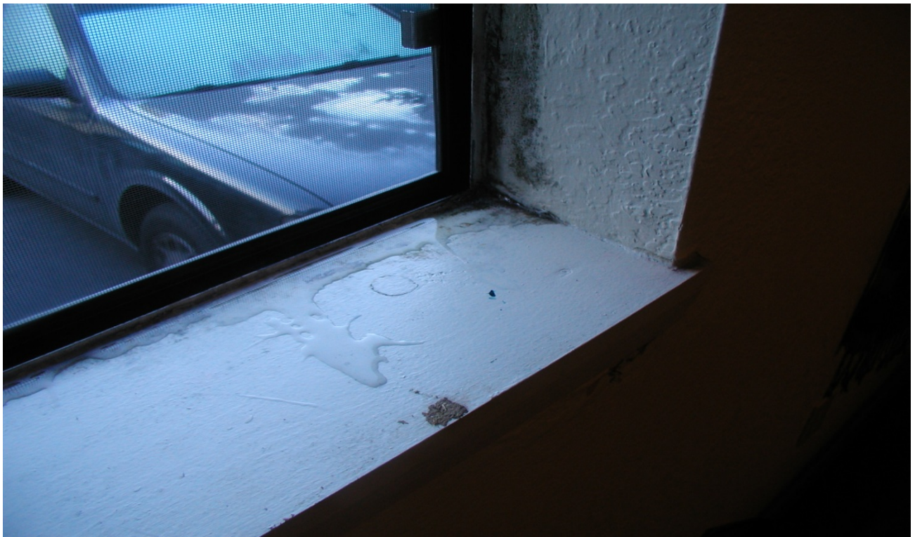
Figura 1. La condensación causada por el exceso de humedad interior en el cristal de una ventana, que se desliza por este y se empoza en el alféizar, empapó la pared y la retorció, suministrando la gran cantidad de humedad que provocó el crecimiento de moho negro visible junto a la ventana.
