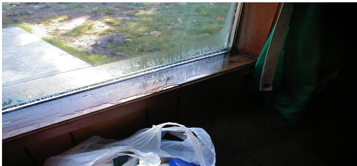
Figura 2. Cuando hay demasiada humedad en el aire (un alto nivel de humedad relativa), en clima frío, se produce condensación indeseada en superficies frescas tales como las ventanas de doble cristal. La humedad se desliza hacia abajo, se acumula en los alféizares, y puede penetrar las cavidades de la pared debajo de las ventanas, causando el crecimiento de moho oculto en la madera y en paredes con respaldo de papel. Las ventanas de un solo cristal son todavía más frías, con lo que se produce la condensación incluso a niveles de humedad normales (por debajo del 40 %) en el interior, y es posible que sea necesario secar los alféizares diariamente con toallas para evitar el crecimiento de moho y los daños por agua.
